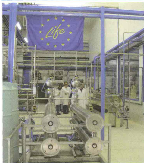
Uno scorcio dell'impianto Re-Waste.
