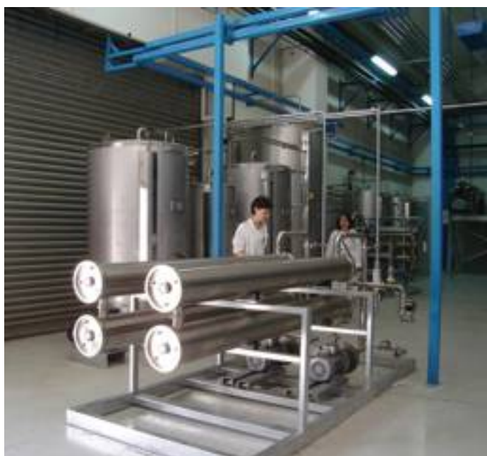
▲ Impianto dimostrativo per il recupero di frazioni biologicamente attive da reflui oleari.
